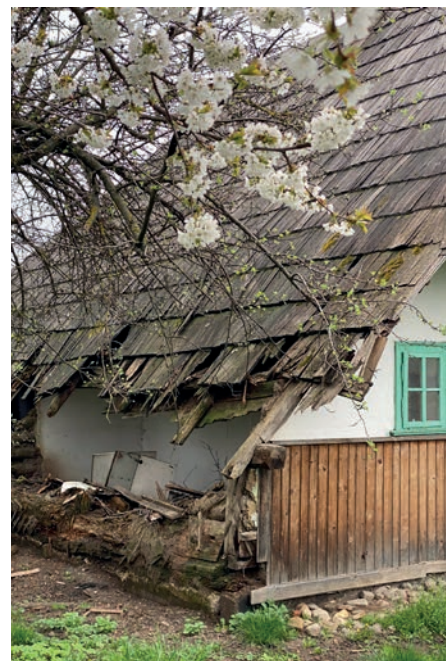
fig 4. Casă degradată din laslovăț.
